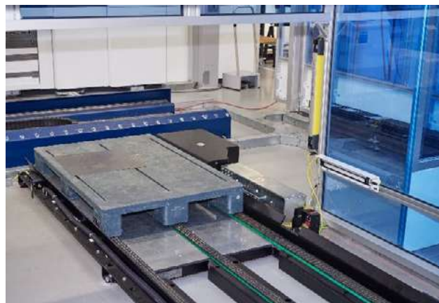
Un dispositivo de seguridad multihaz de la serie MLD 500 de Leuze protege el acceso. También se han instalado sensores de Leuze encargados de detectar la presencia de los palets, así como para la adquisición de datos de pedidos y materiales.
